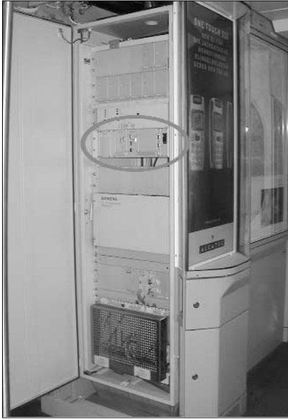
Abb. 4: Diagnosemodul im Schaltschrank eines ICE2
